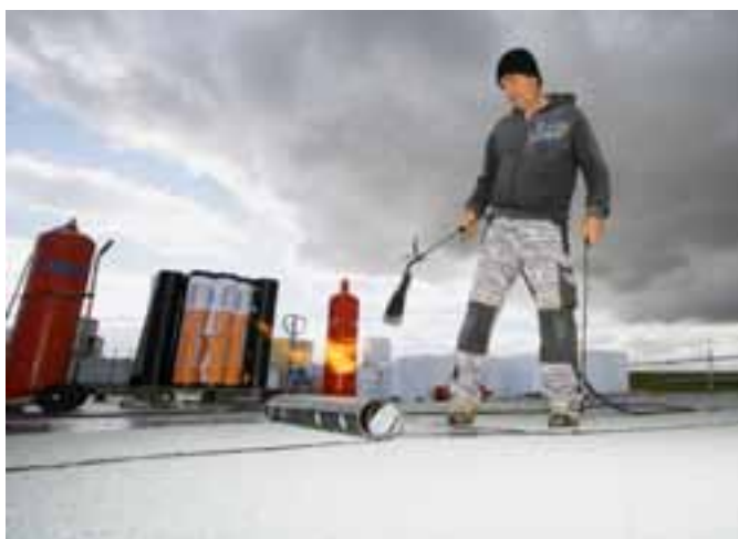
Da der Flachdachaufbau eine Begrünung einschließt, nutzte das Isobau-Team eine Elastomerbitumen-Schweißbahn mit integriertem Durchwurzelungsschutz.
